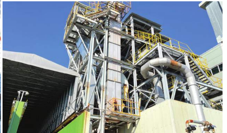
제주 토평 Bio-SRF 발전설비 전경
